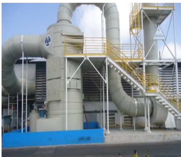
Figura 6: Lavador de gases
